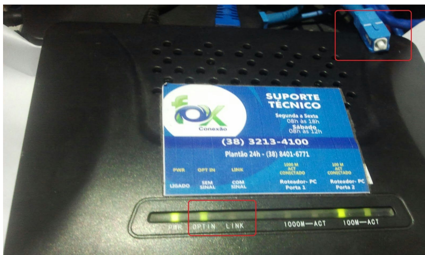
Figura 2: Cabo óptico desconectado
