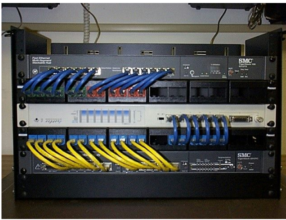
Figura 08: Painéis de conexão (patch panel)
