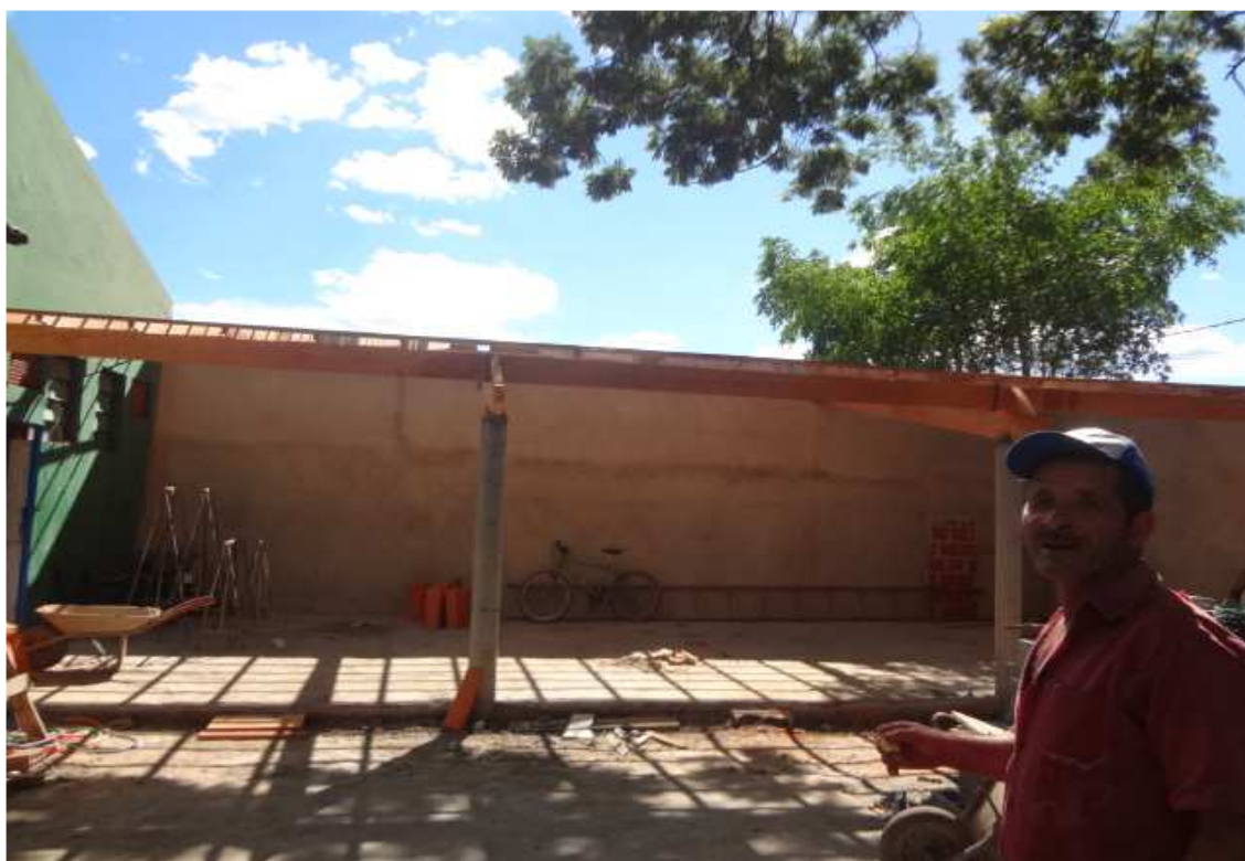
Figura 16: Construção de Galpão para Oficina na Área do Estacionamento FONTE: Arquivo da Escola
